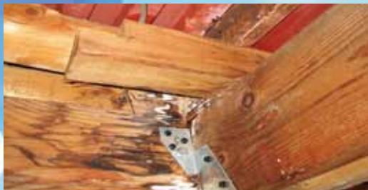
ベランダの軒裏ひどい雨漏りで大事な柱が腐りかけています。
